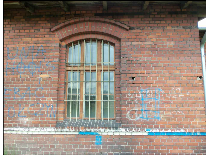
FOTOGRAFIA OKNA DREWNIANE DO RENOWACJI
